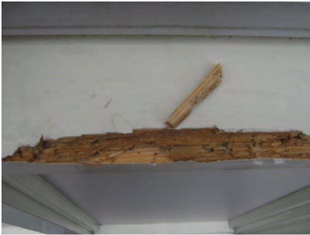
Slechte houtkwaliteit. Delaminatie.
