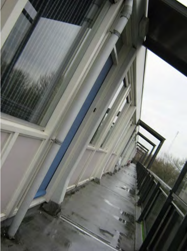
Bovenste galerij vertoont de meeste schade.
