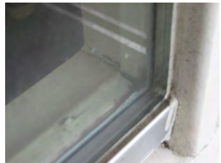
Scheur binnen waardoor vochttransport van binnen naar buiten plaats vindt.
