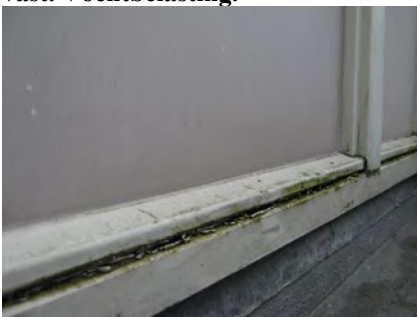
Door opbouw van mos geen ventilatie.
