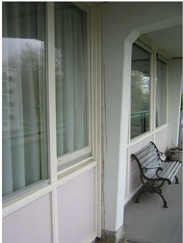
Waterschade galerij door lekkage dilatatievoegen.
