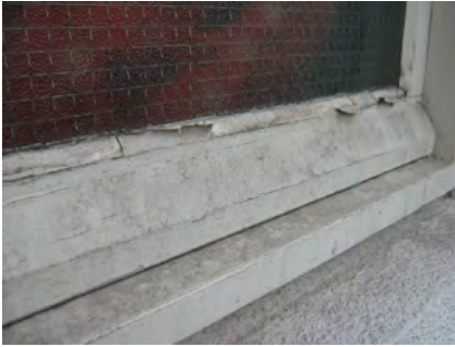
Kelderraam stopverf einde levensduur.
