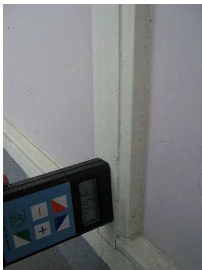
Paneel niet belucht geplaatst dus vocht kan niet weg.
